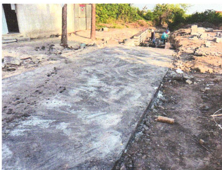
FOTO 03 - PAVIMENTAÇÃO EM CONCRETO, COM ESPESSURA DE 7 CM, COM ACABAMENTO FEITO UTILIZANDO ALISADORA DE CONCRETO (HELICOPTERO), INCLUIDO TELA DE AÇO SOLDADA NERVURADA CA60
